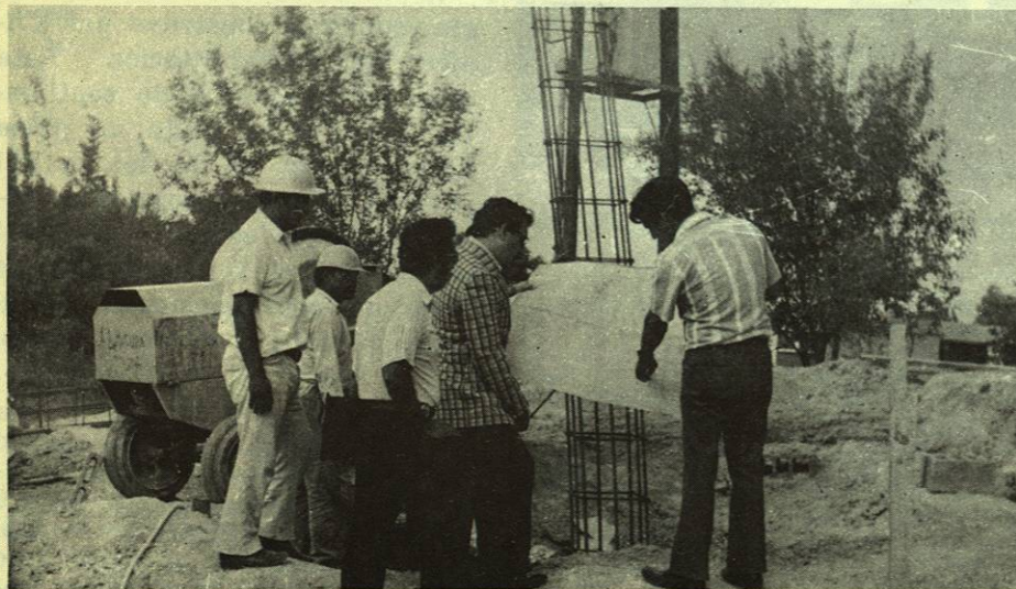
EL ARQUITECTO GERARDO GARZA CORTES, CONOCIENDO EL PLANO DE LO QUE SERAN LOS LABORATORIOS DE IDIOMAS EN LA FACULTAD DE FILOSOFIA Y LETRAS, EN PLENOS TRABAJOS DE CIMENTACION.
