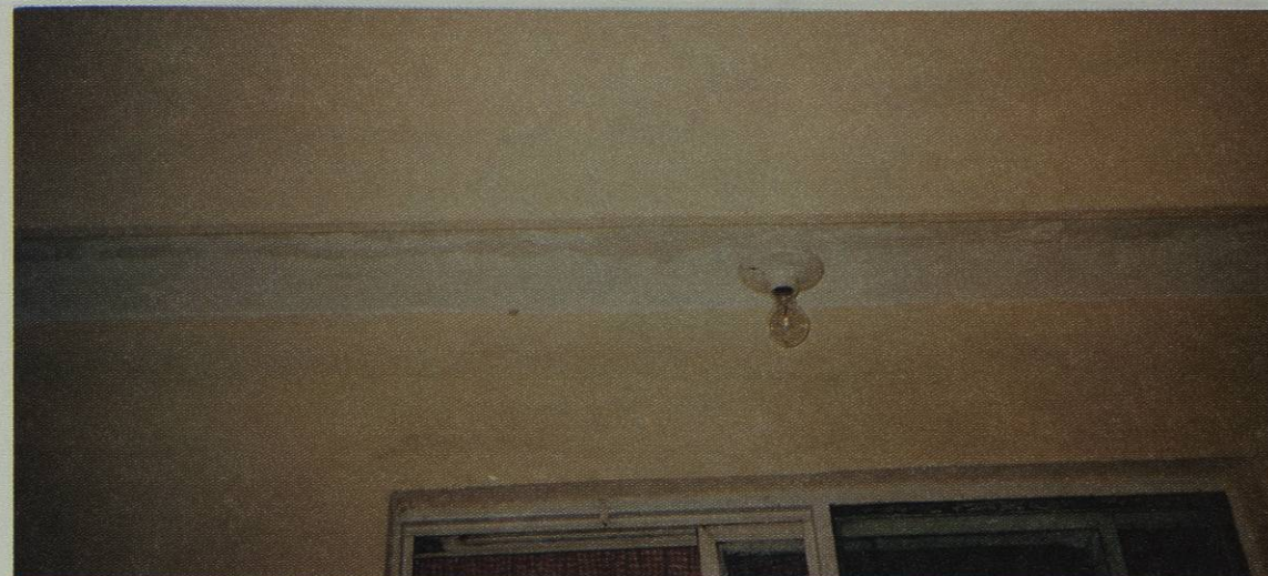
Se encontró humedad en los muros y en los techos, hongos y manchas por eflorescencia.
