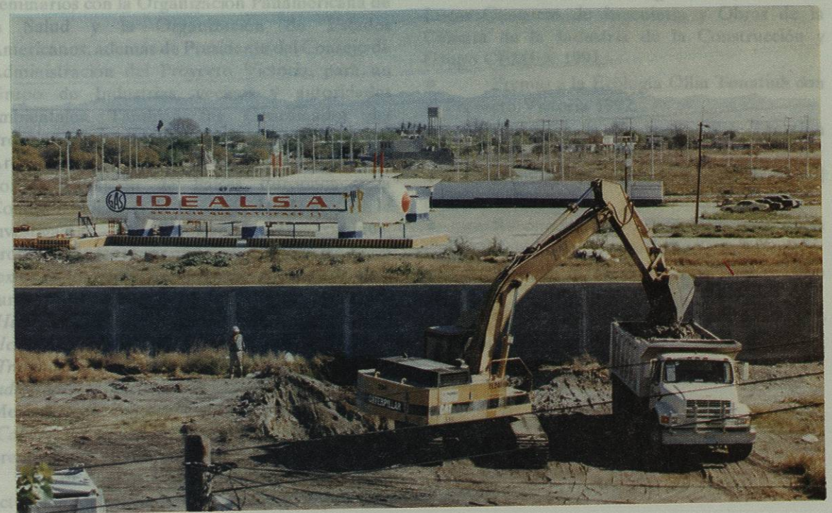
La proximidad de una gasera representó un riesgo adicional.
