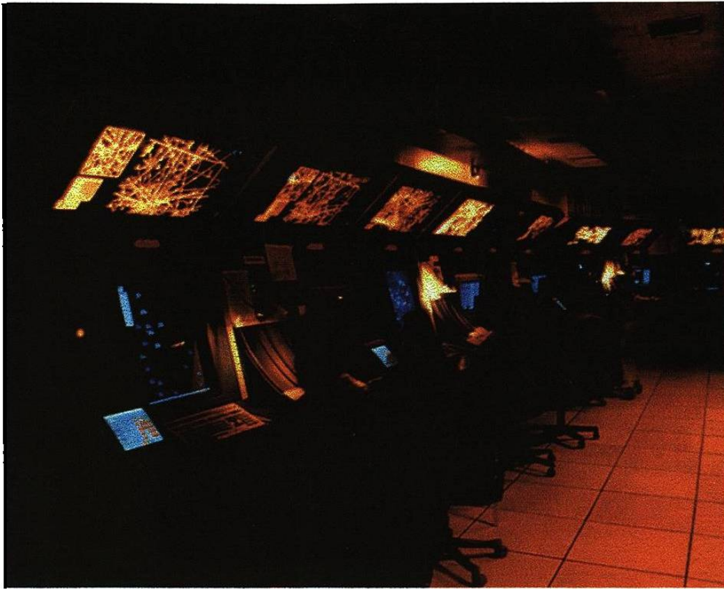
Fig. 9.7 Centro de control
