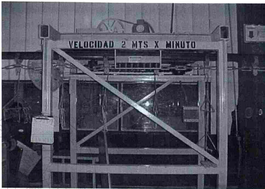
No. 1 Cadena transportadora / transmisión del horno de pintura
