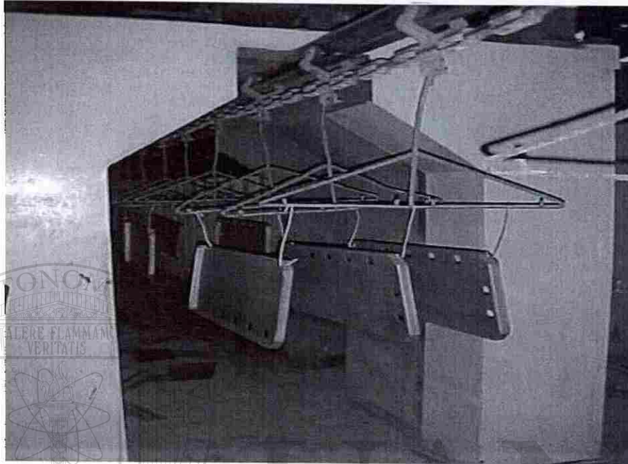
No. 3 Entrada al horno de pintura
