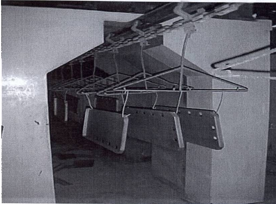
No. 3 Entrada al horno de pintura
