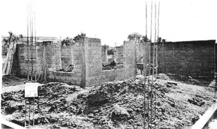
Figura 16. Etapa Inicial del Proceso de Construcción. Cimientos y Levantado Inicial de Paredes en Tabique.
