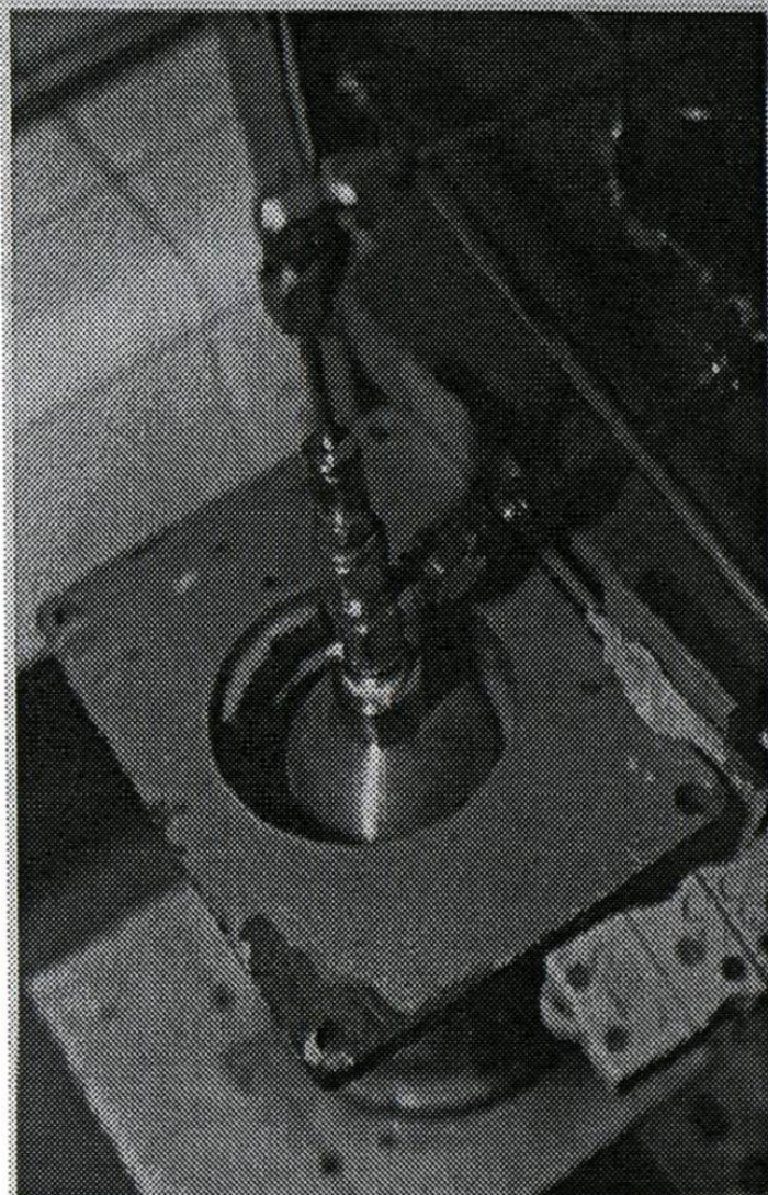
Fot. S20 Trampa para atrapar Sólidos y/o Condensado
