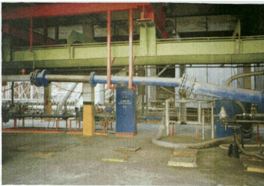
Foto 3-11 Vista del área de la plataforma del Horno N° 10 donde se muestra la tubería de alimentación de coque de petróleo al quemador principal antes de implementar el Mantenimiento Autónomo
