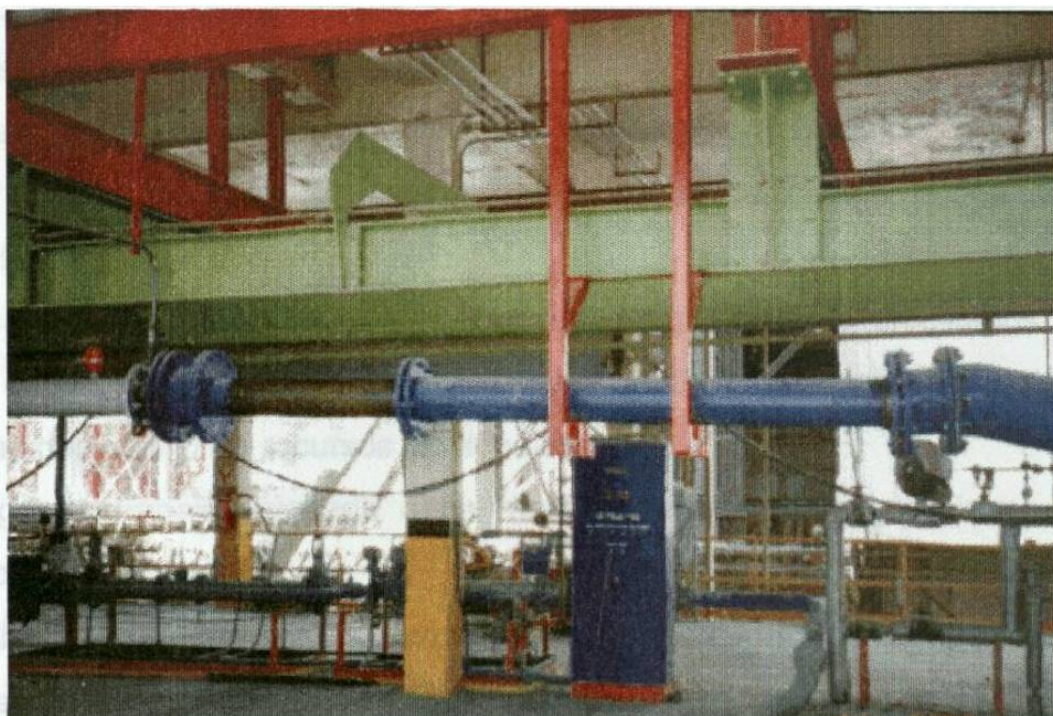
Foto 3-12 Vista del área de la plataforma del Horno N° 10 donde se muestra la tubería de alimentación de coque de petróleo al quemador principal después de implementar los pasos 1 y 2 del Mantenimiento Autónomo.
