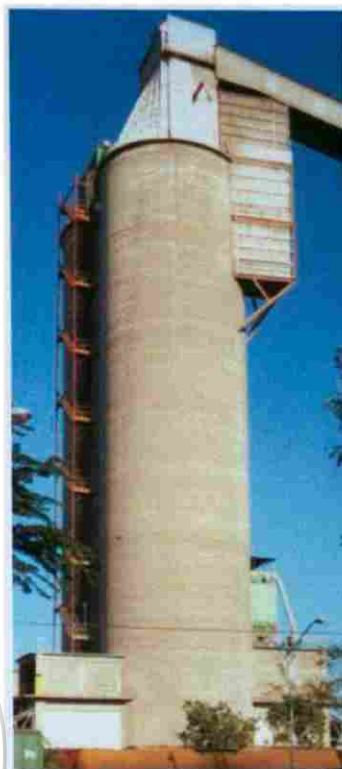
Fotografía 3-5. Vista lateral de silos gemelos, para almacenamiento de cemento.
