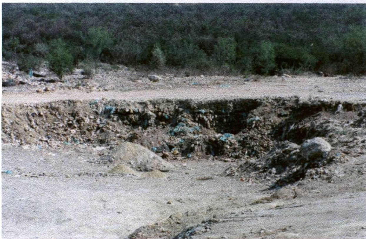
Arriba: Rellenos sanitarios agotados, descubiertos al tratar de utilizar el predio. Abajo: Rellenos sanitarios expuestos al intentar construir sobre el antiguo relleno sanitario.
