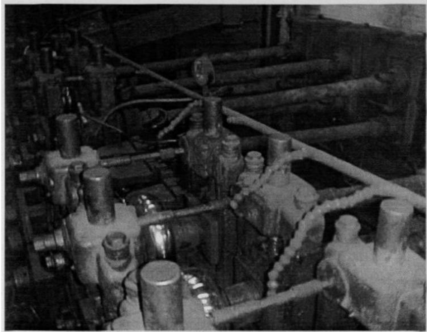
Foto 6.11 Tubería de enfriamiento
