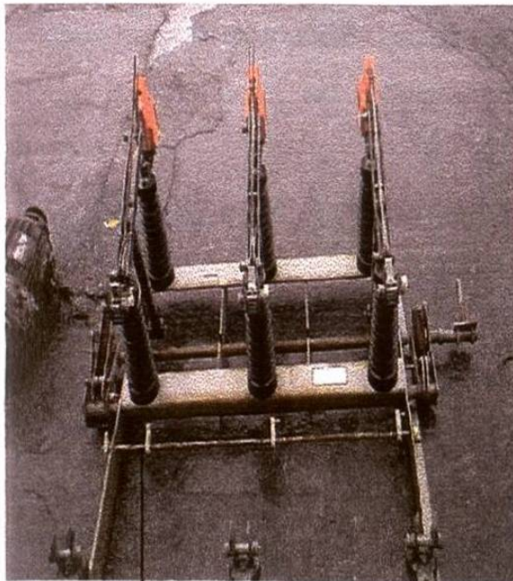
Servicio de 13.8kv.a 34.5 kv.
