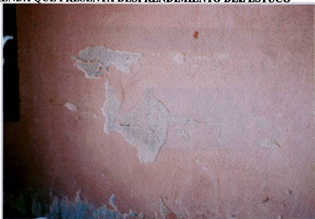
20) Río Yukón 224 Col. Pueblo Nuevo 5º Sector, Apodaca Nuevo León. VIVIENDA QUE PRESENTA DESPRENDIMIENTO DEL ESTUCO
