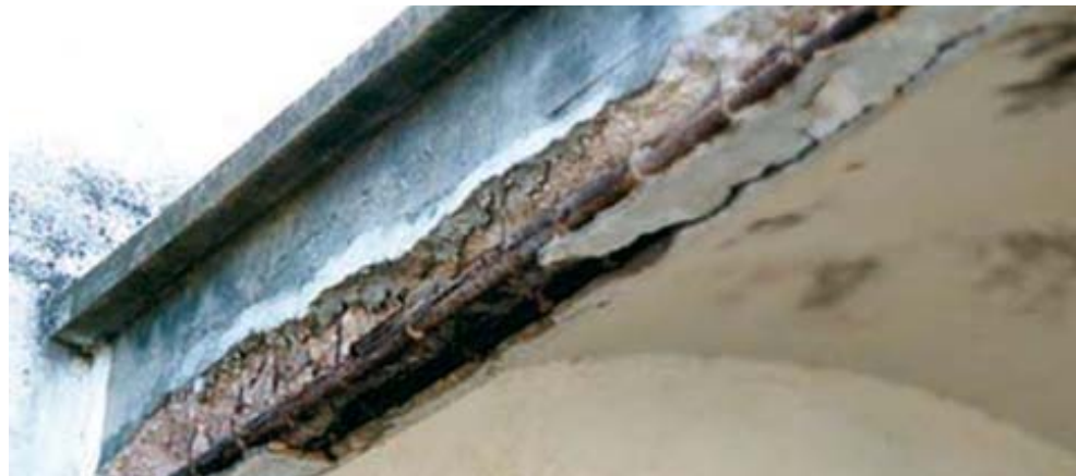
Figura 8. Corrosión del acero de refuerzo.
