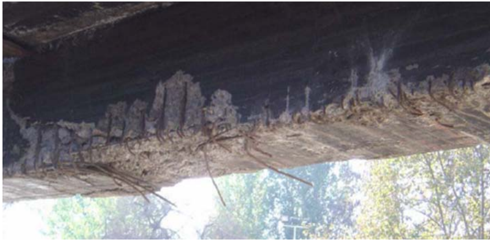
Figura 18. Corrosión uniforme de un acero de refuerzo como resultado de la carbonatación del concreto.
