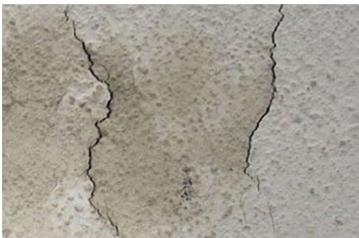
Figura 18. Retracción por secado a edad temprana en una losa de azotea. 10
