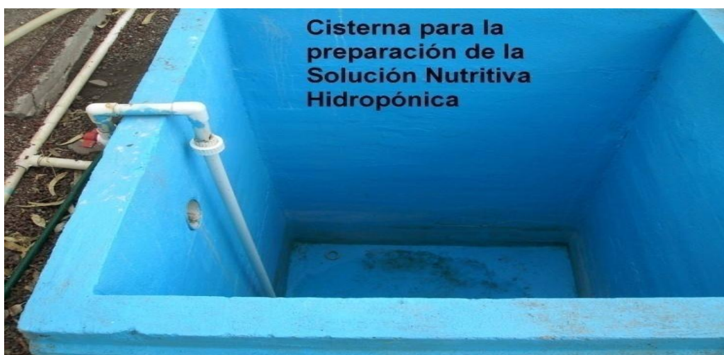
Fotografía 2. Cisterna para preparar la SNH con un volumen de 2.5 m 3 .
