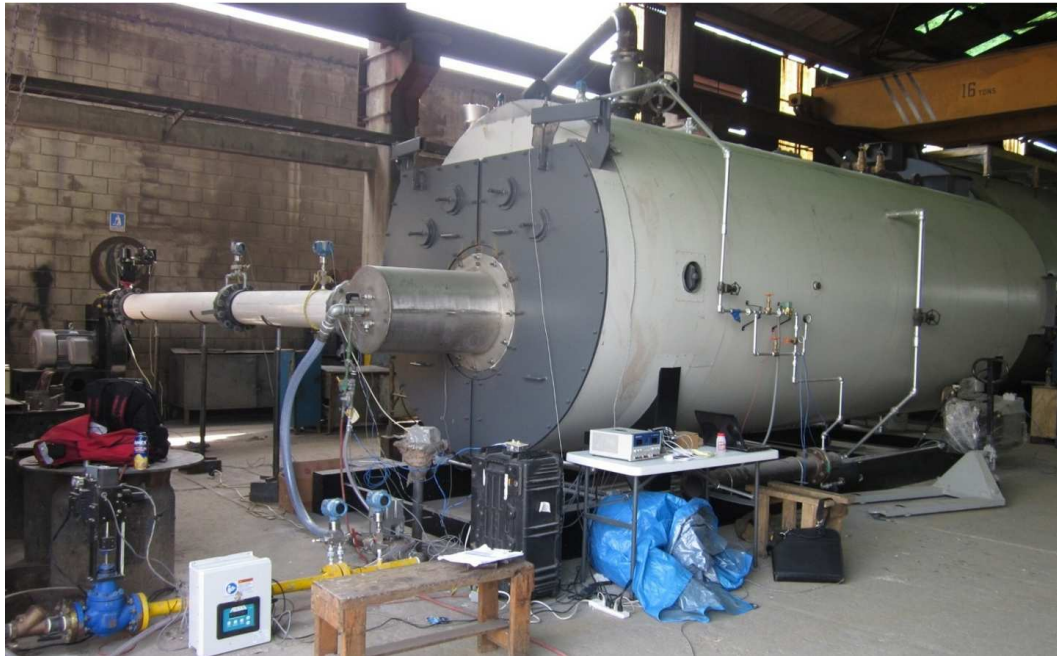
Figura 2.11: Imagen general de la instalación experimental.
