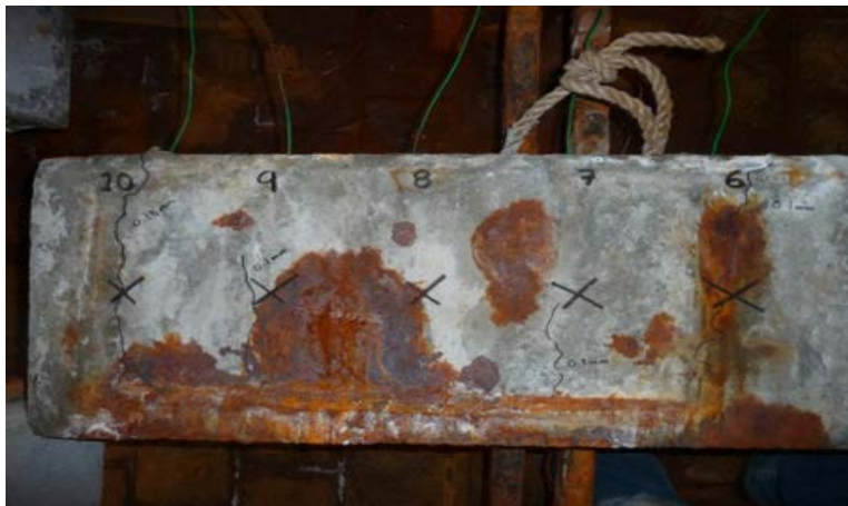
Figura 52. Condición superficial de las vigas sometidas al deterioro acelerado (65 días de humectación y secado + aplicación de la corriente).
