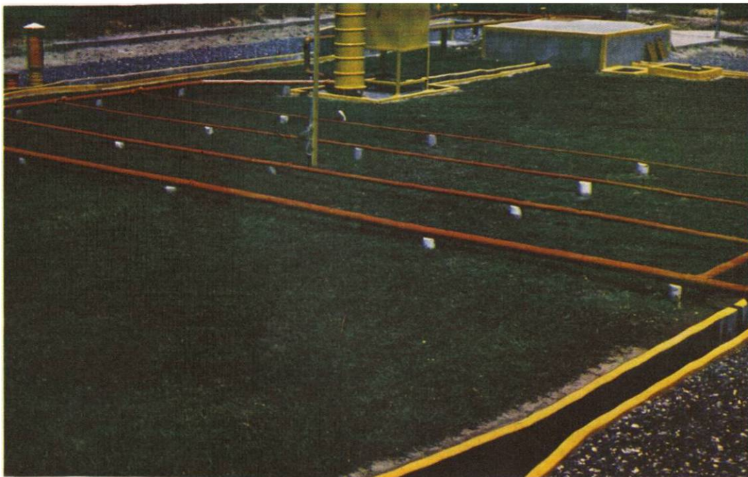
Foto 9. - Vista general de tuberías de prueba.
