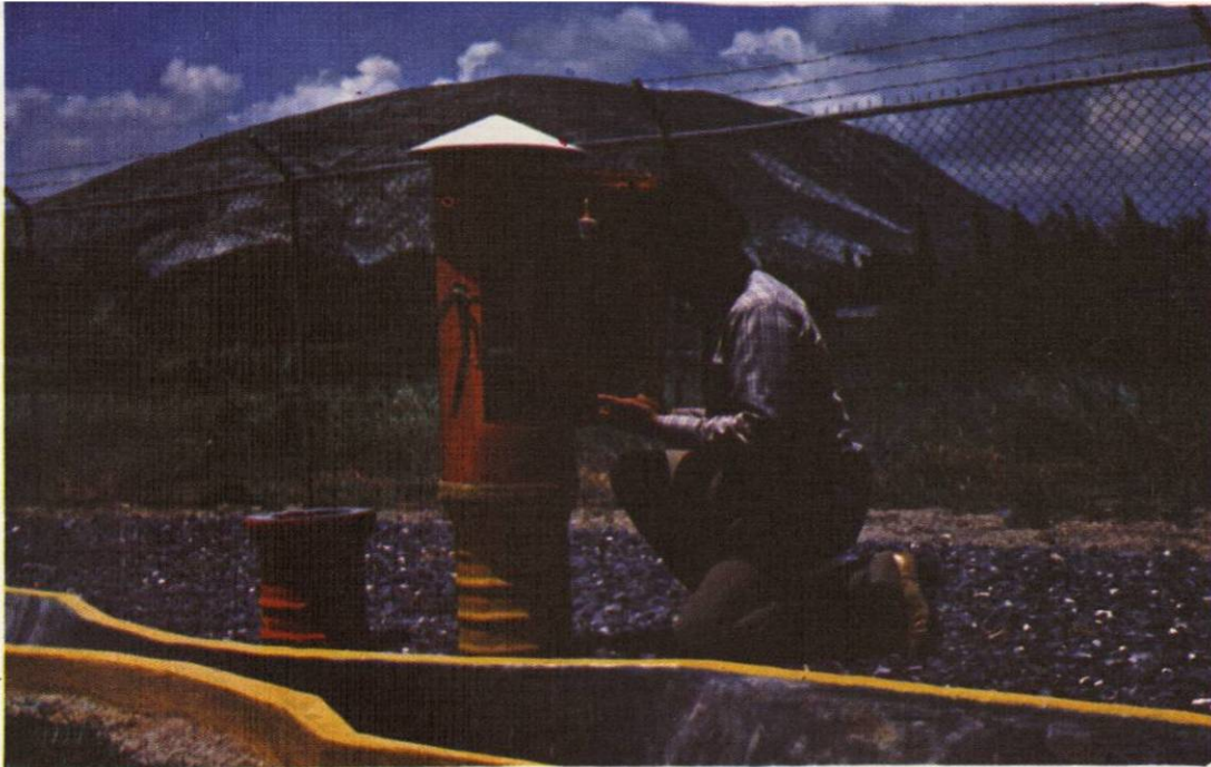
Foto 6. - Vista de limnógrafo instalado en Aforador - - - Parshall.
