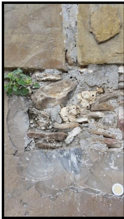
Figura 33 Descamación en las areniscas causante de pérdida de material. Se aprecian manchones de mortero. En una de las rocas sobre sale una capa de la superficie original de la misma, típico aspecto de descamación en las areniscas.
