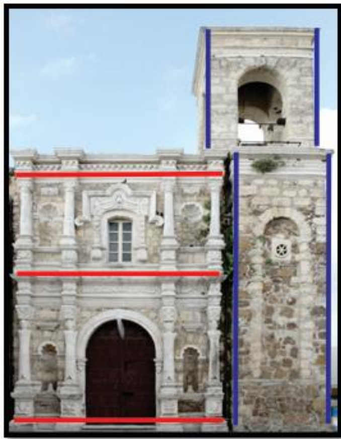
Figura 10 Fachada principal del Templo. Las líneas en color rojo muestran los dos cuerpos rectangulares horizontales y las líneas en color azul muestran el cuerpo vertical que representa el campanario.
